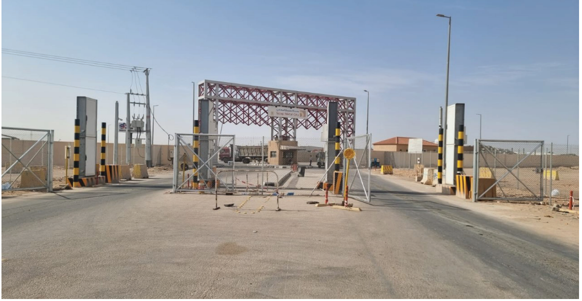
بوابات الكشف الإشعاعي بمدينة تجمع المعادن بمنطقة الرياض
