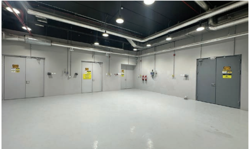
تظهر الصورة الخلايا الحارة لمنطقة تصنيع المواد المشعة.
